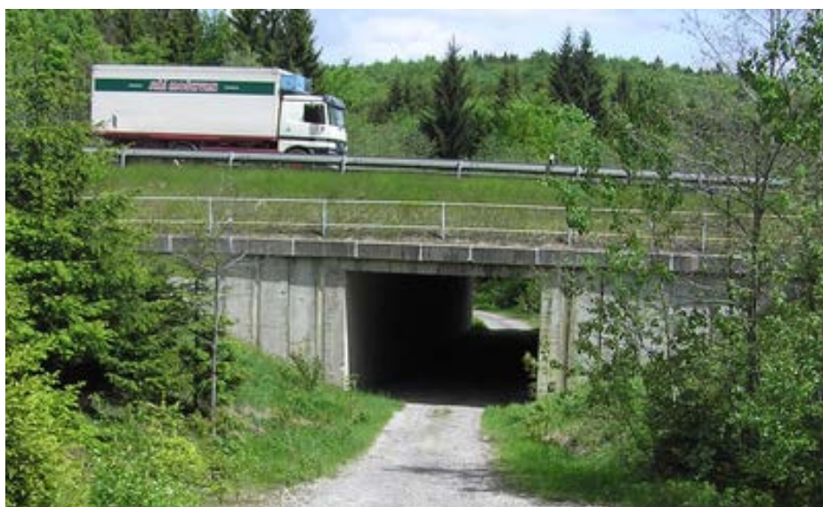
Fig. 103. Acest tip de subtraversare pentru un drum forestier nu reprezintă un pasaj potrivit pentru faună. Dimensiunile: lățime = 6 m, înălțime = 5 m, lungime = 33 m ( OI = 0,9 ) sunt insuficiente pentru mamiferele mari, iar mamiferele mijlocii cum ar fi căpriorul sau mistrețul vor folosi acest tip de trecere numai atunci când perturbările sunt complet eliminate (pereți de protecție de-a lungul autostrăzii, activități umane limitate). Republica Cehă, autostradă D1. (Foto: Václav Hlaváč)
