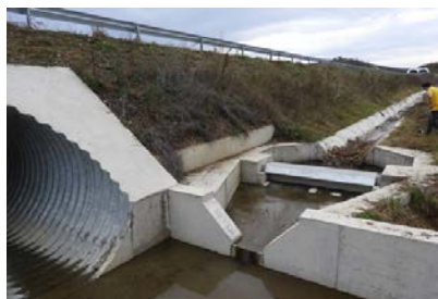
Fig. 65. Canalele cu diametru mai mare ar trebui să fie întotdeauna adaptate pentru a permite deplasarea speciilor pe sub autostradă. Ieșirea este, în acest caz, amenajată tehnic într-un mod care nu oferă nicio posibilitate pentru anumite specii să folosească acest canal pentru a traversa autostrada. În plus, poate deveni o capcană periculoasă pentru animale mici (precum amfibieni, mamifere). (Foto: Václav Hlaváč)
