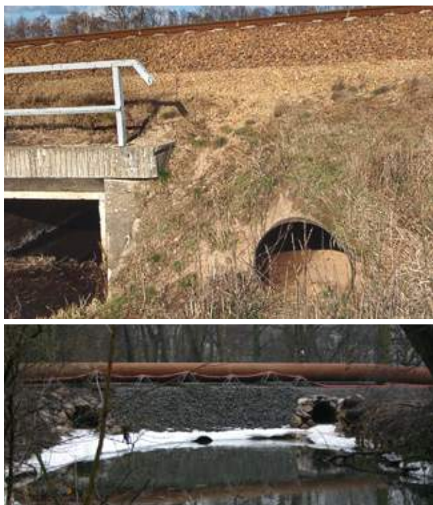
Obr. 10.47 Tunely pro vydry jsou vhodným řešením tam, kde je pro tento druh most neprůchodný, nebo kde je dopravní infrastruktura vedena po hrází rybníka nebo vodní nádrže. © Lukáš Poledník
