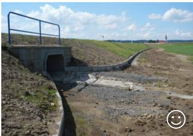
Obr. 10.58 Trvalé zábrany mají za cíl navedení migrujících obojživelníků ke vhodným podchodům. Vždy se budují na obou stranách komunikace – ve směru jarní migrace do vodních biotopů a též směrem zpět do biotopů terestrických. © Jaromír Maštera
