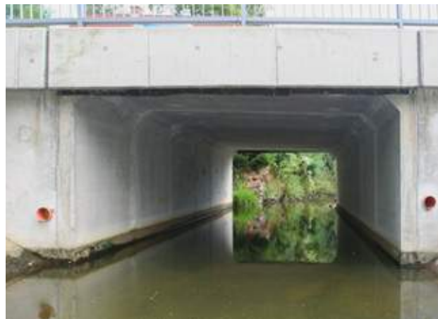
Obr. 4.4 Most bez suchých břehů vytváří „psychologickou bariéru“ pro vydry. Přestože vydra fyzicky schopná takový most podplavat, dosavadní zkušenosti ukazují, že většina jedinců tyto podchody nevyužívá a místo toho přechází vrchem přes silnici. © Václav Hlaváč
