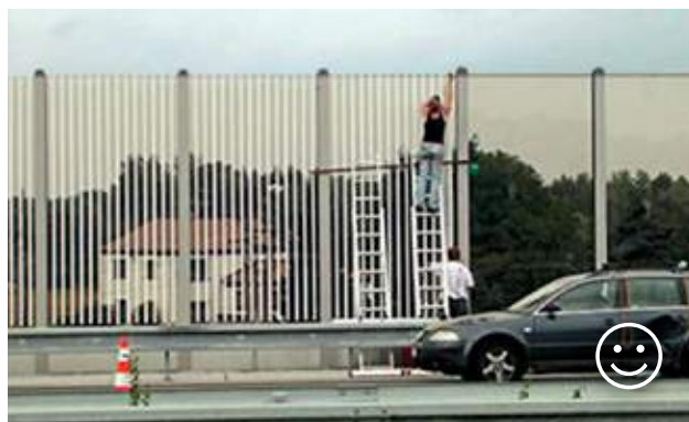
Obr. 10.60 Instalace svislých pruhů nalepením na protihlukové stěny na dálnici D47 v České republice. V roce 2008 bylo na úseku pouhého 1 km této dálnice mezi Bohumínem a Ostravou nalezeno téměř 200 mrtvých ptáků během 6 měsíců. Po instalaci svislých pruhů klesla mortalita prakticky na nulu. © Jan Mayer
