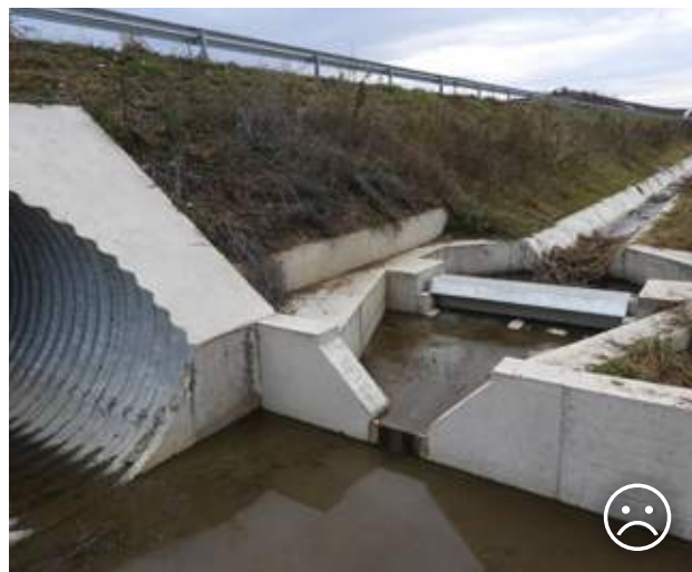
Obr. 9.18 Propustky o větším průměru by měly být uzpůsobeny také pro průchod fauny pod dálnicí. V tomto případě je výtok technicky řešen tak, že možnost využití propustku jako průchodu zcela vylučuje. Může navíc představovat smrtící past pro malé živočichy (obojživelníky, malé savce), kteří se jím pokusí projít. © Václav Hlaváč
