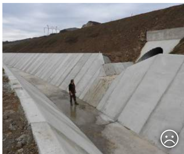
Obr. 9.19 Masivní betonový žlab pro odvedení srážkové vody z dálnice má velmi rušivý účinek na krajinu, zvyšuje bariérový účinek a neumožňuje použití propustku jako průchodu pro faunu. Takové řešení rovněž představuje past pro menší živočichy, kteří nemají šanci se dostat z betonového kanálu ven. © Ivo Dostál
