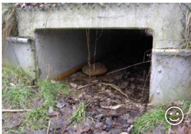
Obr. 10.43 Rámový propustek představuje dobré řešení pro obojživelníky, plazy a savce do velikosti lišky nebo jezevce.
