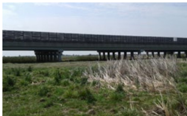
Obr. 6.40 Viadukt je obvykle optimálním řešením pro překonání mokřadů. Nezbytná však je instalace ochranných stěn, které omezí rušivé vlivy a úmrtnost ptáků v důsledku střetů s vozidly. Dálnice M3, Maďarsko. © András Szirányi
