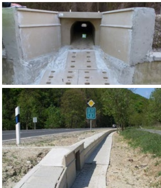
Obr. 10.48 Tunel pro obojživelníky je dobrým řešením pro překonání úzkých komunikací nižší třídy. Pro správnou funkčnost takového podchodu je nezbytnou podmínkou vybudování naváděcích bariér. © Andrés Weiperth
