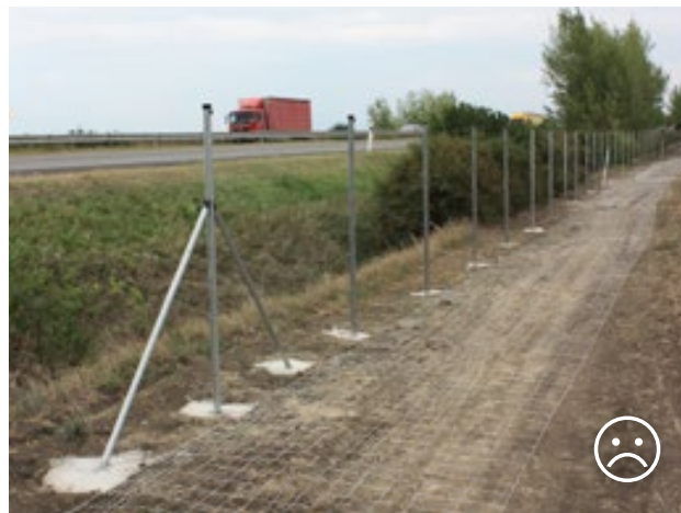
Obr. 9.24 Vzrostlá vegetace mezi dálnicí a oplocením živočichy přitahuje, protože se často jedná o jedinou vegetaci v intenzivně využívané zemědělské krajině. Je-li plot poškozen, zvířata se mohou snadno dostat mezi plot a dálnici, kde jsou uvězněna. Plot navíc není přes stromy z dálnice vidět, poškození proto není často včas odhaleno a vzrůstá tak riziko střetů zvířat s vozidly. © archiv NDS
