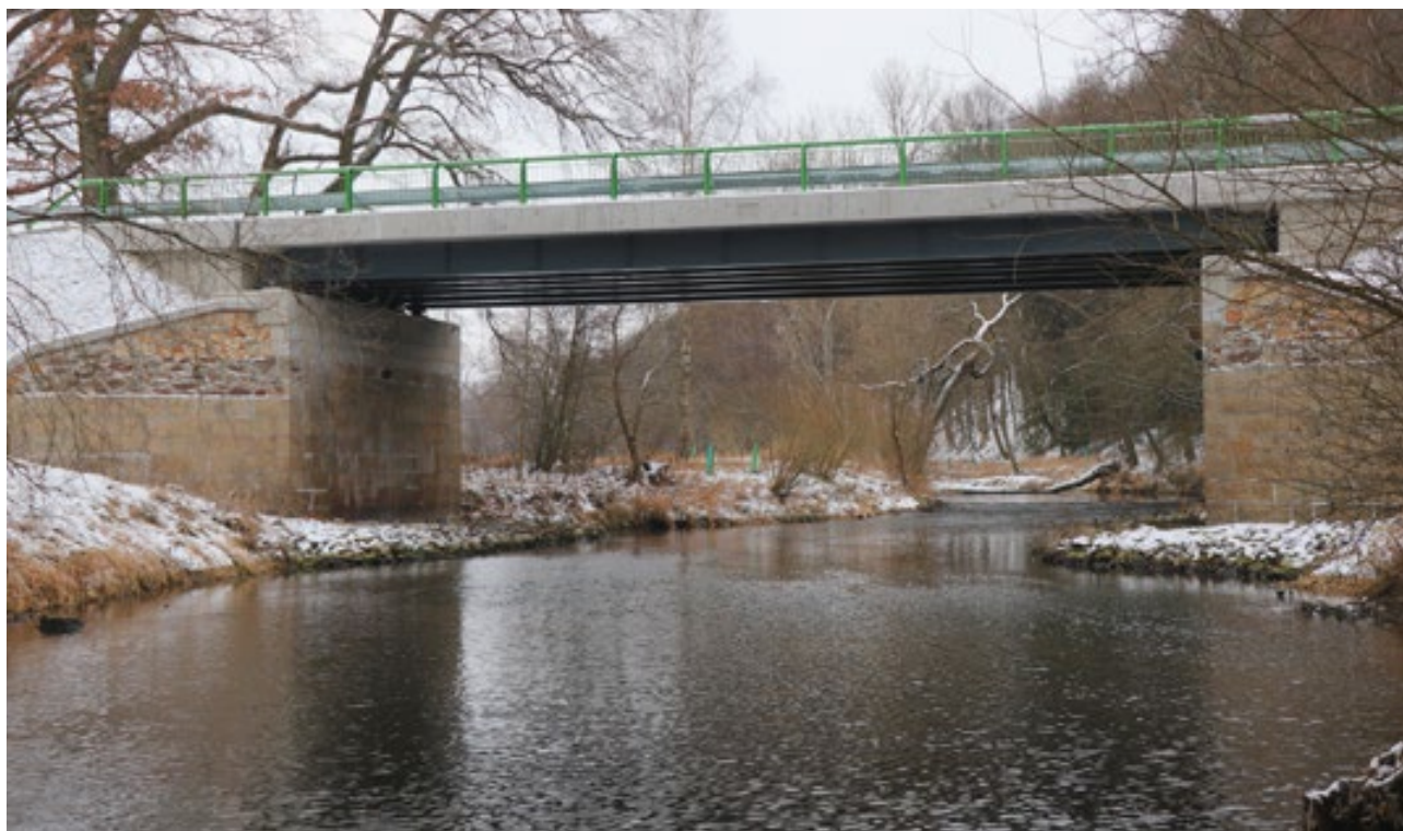
Obř. 10.1 Mosty přes vodoteče mohou být snadno upraveny tak, aby živočichům umožnily bezpečný průchod pod komunikací. Je nezbytné zachovat přirozené břehy pro návaznost terénu. © Václav Hlaváč
