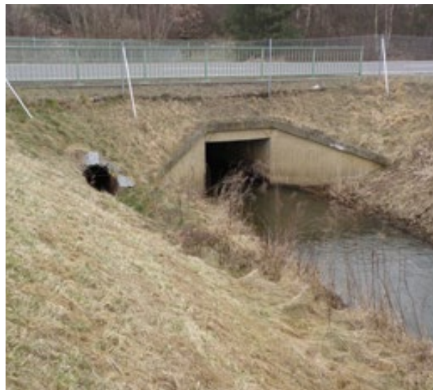
Obr. 10.14 Pokud není možné nevhodný most upravit tak, aby plnil funkci průchodu pro dané druhy, může být dodatečně vybudován souběžný vydrí tunel. Pro lepší navedení živočichů k otvoru průchodu se doporučuje modulace terénu a použití naváděcích bariér. © Lukáš Poledník
