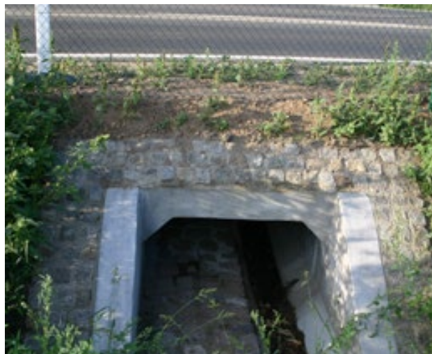
Obr. 9.5 Obdélníkové propustky vhodné jako průchod pro menší savce do velikosti lišky nebo jezevce jsou relativně snadným konstrukčním řešením u dopravní infrastruktury v rovinaté krajině. © Lukáš Poledník
