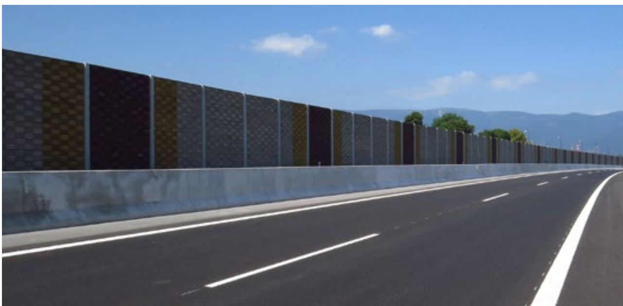
Obr. 4.8 Protihluková stěna eliminuje vliv rušení, zároveň ale zvyšuje bariérový efekt. © Tomáš Flajs
