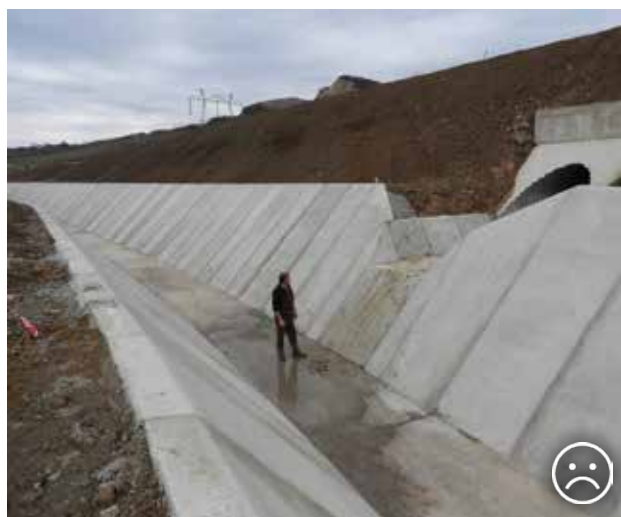
Рис. 9.19. Масивна бетонна конструкція каналізаційного стоку не дає можливості використовувати кульверти як переходи для фауни, а тому є негативним елементом для міграції тварин. Вона також є пасткою для дрібних тварин, які не можуть самостійно вибратися із конструкції. © Іво Достал
