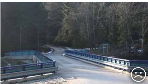
Рис. 10.31. На цьому мості з лісовою дорогою встановлено непрозорі перила. Однак поверхня асфальту є абсолютно непридатною для переміщення тварин, тому це рішення загалом є недостатнім. Чехія, D1, Jihlava. © Вацлав Главач
