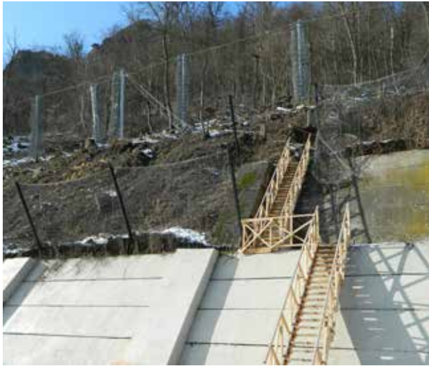
Рис. 9.13. Крутий схил закріплений огорожею або дротяною сіткою від падаючого каміння. Ці заходи іноді необхідні для стабілізації схилів, але водночас вони є посиленням бар'єрного ефекту та руйнуванням придорожніх ділянок, які є часто природними типами оселищ. Потрібно реалізувати більш ефективне рішення, якщо можливо. R2, Зволєн, Словаччина. © Мірослав Ярний
