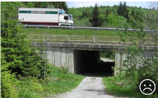
Рис. 10.40. Цей підземний перехід з лісовою стежкою не є відповідним переходом для фауни. Розміри: ширина = 6 м, висота = 5 м, довжина = 33 м (індекс відкритості = 0,9) є недостатніми для ссавців великого розміру. Ссавці середнього розміру, такі як косуля або кабан, використовують підземні переходи лише тоді, коли вплив автотранспорту на прилеглу територію є незначним (наявність захисної стіни вздовж дороги, прояв обмеженості діяльності людини). Чеська Республіка, автомагістраль D1. © Вацлав Главач
