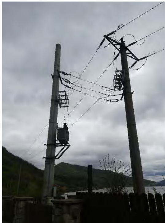
Stâlp cu transformator (stânga) și stâlp comutator (dreapta).
