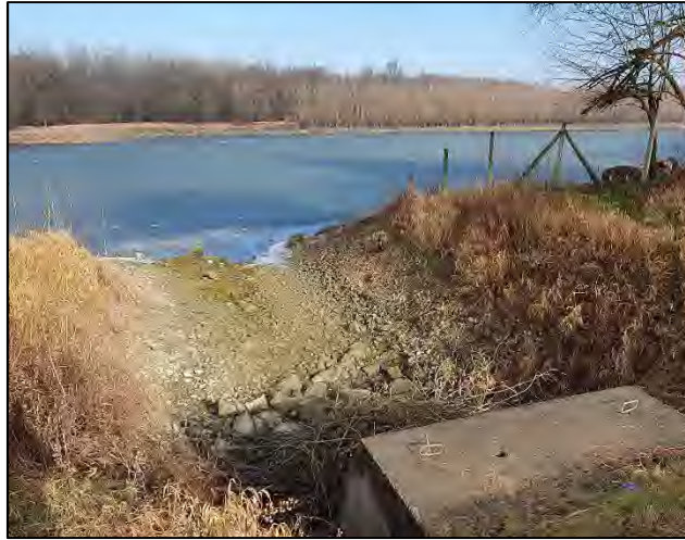
5.4. kép – Bédai szivattyútelep Külső-Béda felé eső beömlő nyílása
