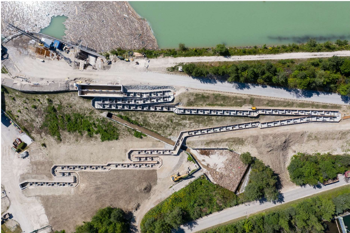
30. ábra Példa egy Ausztriában épített, 26 méteres akadályt leküzdő halastóra (© VERBUND AG)
